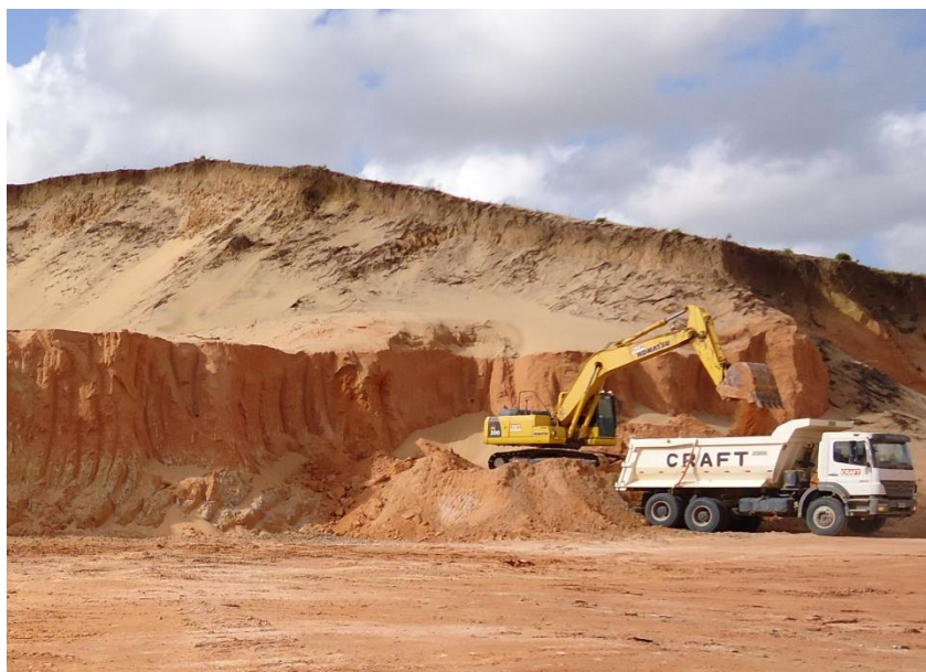
Figura 4 - Na área de empréstimo dentro da ADA pode-se observar perfil do tabuleiro pré-litorâneo.
